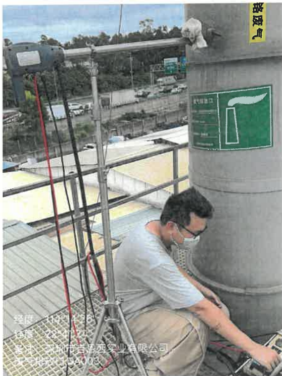
废气排放口 DA003
