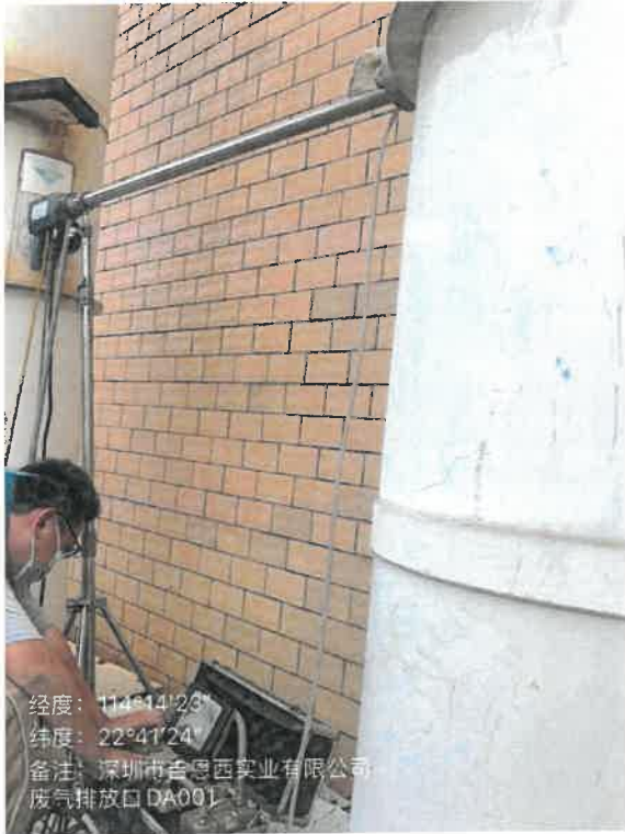
废气排放口 DA001
