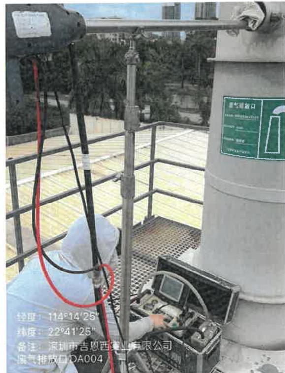
废气排放口 DA004
